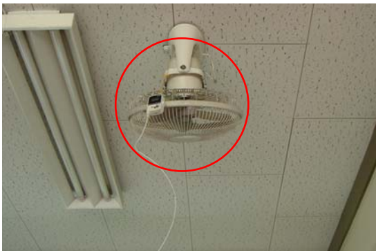
床上 2.0m に設置の温度測定器 (教室の天井位置程度の高さ)
