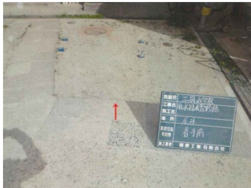
雨水排水管の排水不良
