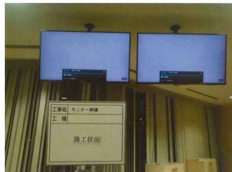
新設モニターチャンネル調整
