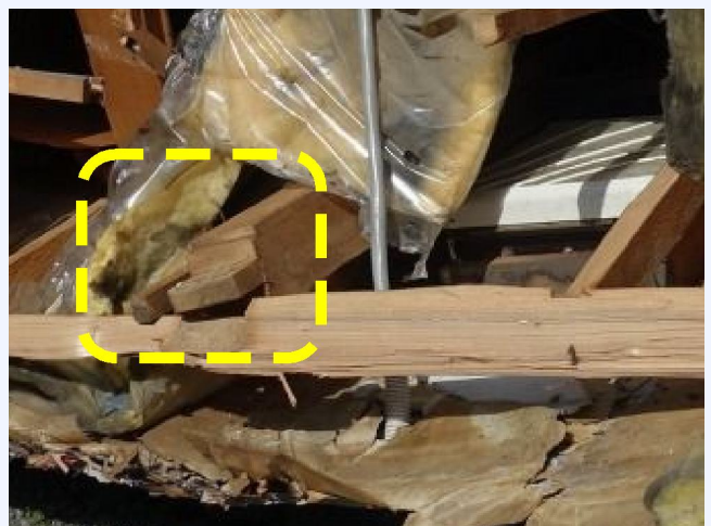
倒壊した木造住宅の柱頭部(金物確認できず)
