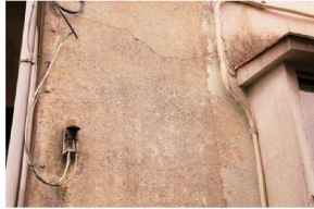
外壁のひび割れ・こけ
