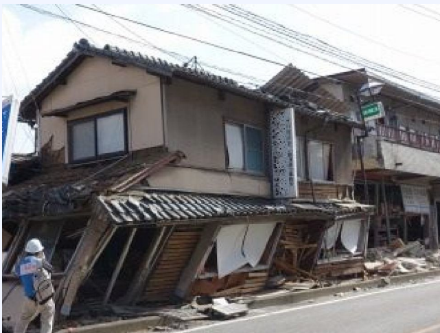
大きく傾斜した店舗併用住宅
