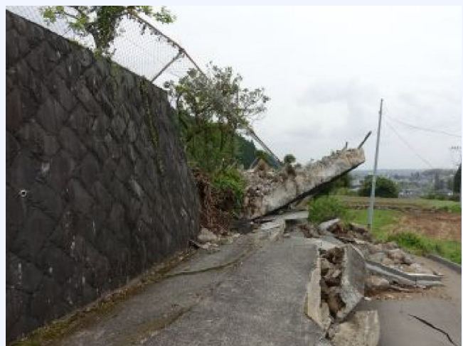
崩壊した擁壁
