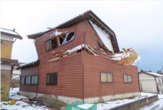
2階が崩壊した木造住宅
