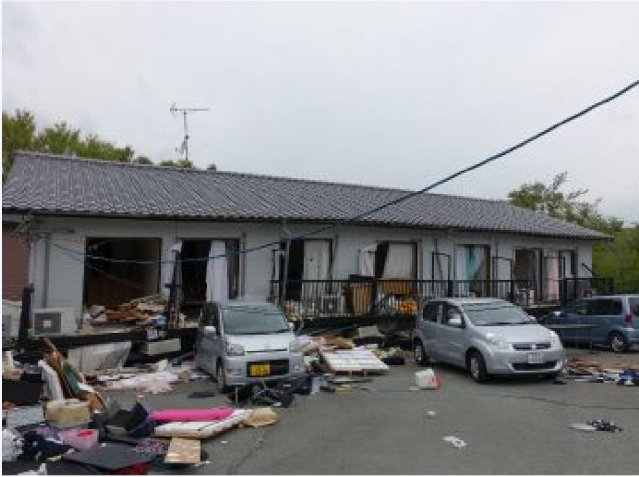
1階が層崩壊した2階建て木造アパート
