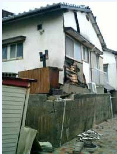
擁壁と外壁の破壊
