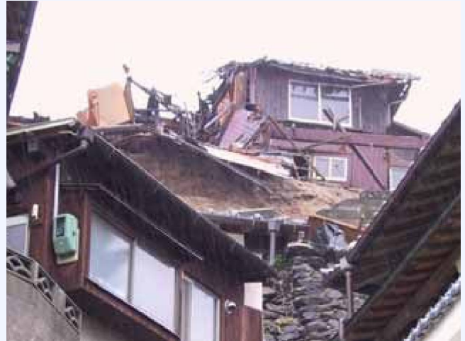
敷地と建物の崩壊
