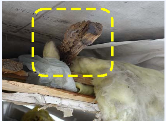
アパートの筋交い端部(蟻害による断面欠損)
