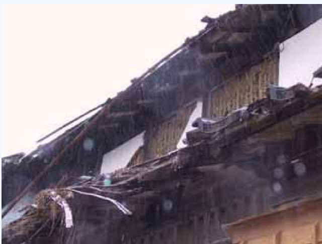
土壁及び屋根の損傷
