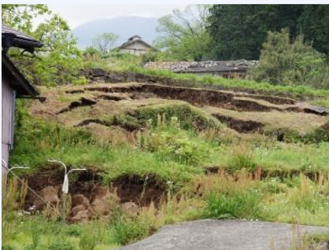
地盤に生じた亀裂
