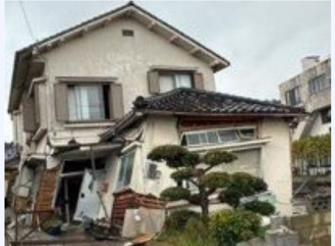
大きな残留変形のある木造家屋
