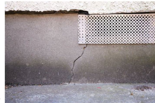
基礎のひび割れ
