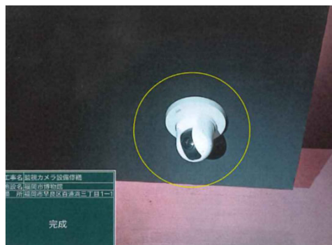
新設カメラ完成
