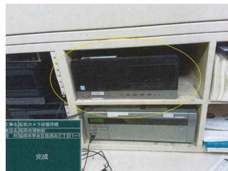
既設モニターチャンネル調整
