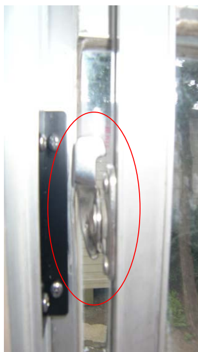
④クレセント(閉状態)での引き戻り状況
