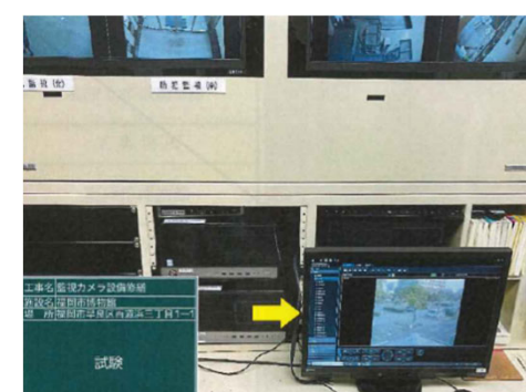
既設モニター試験
